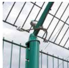
Mise à la terre
