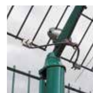
Mise à la terre
